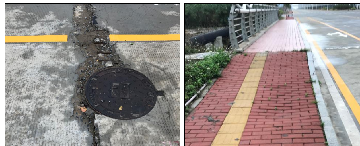
现状石化六路（南）破损段路面及人行道不均匀沉降
